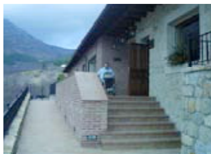
Escalera sin pasamanos laterales de sujeción
