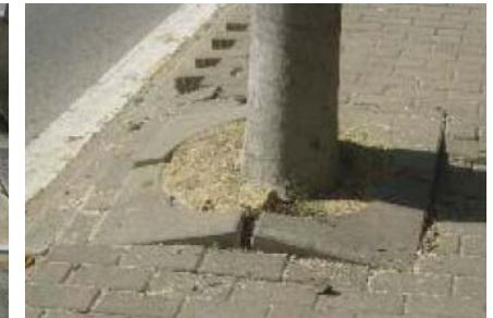
Raíces que levantan el pavimento
