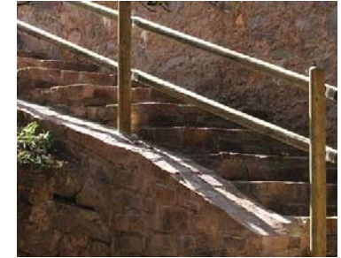
Ausencia de rodapié
