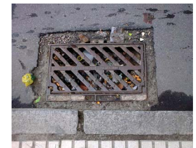
Suciedad y falta de mantenimiento
