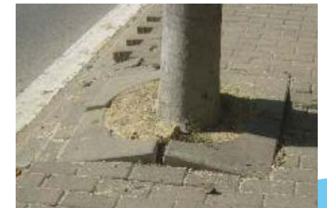
Raíces que levantan el pavimento
