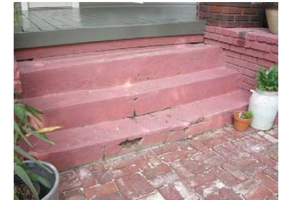
Escalones rotos y/o deslizantes
