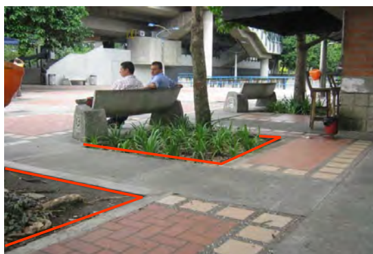
Los arboles en este espacio publico no cuentan con alcorques, lo que limita pone en riesgo el paso de peatones.
