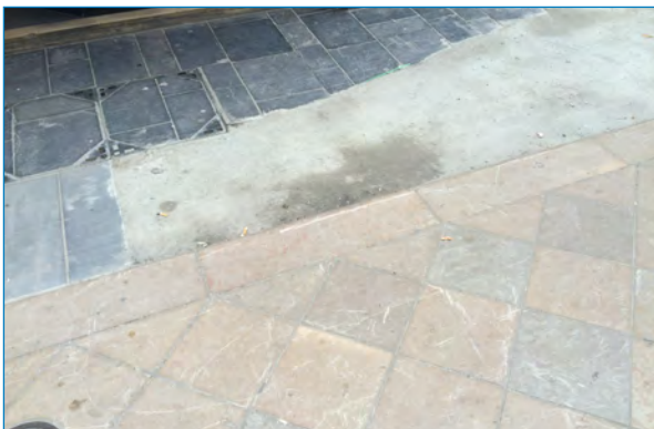
Figura 47. Plataforma mixta. Bordeaux, Francia./ Fuente propia.
