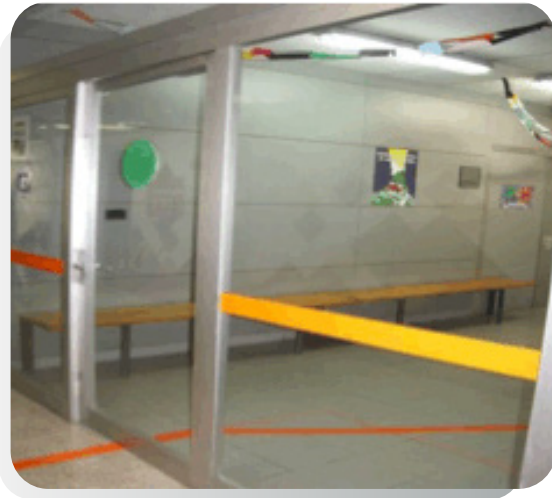
Señal puerta de entrada y superficie acristalada. (Paternáin et al. s/f, p.12)
