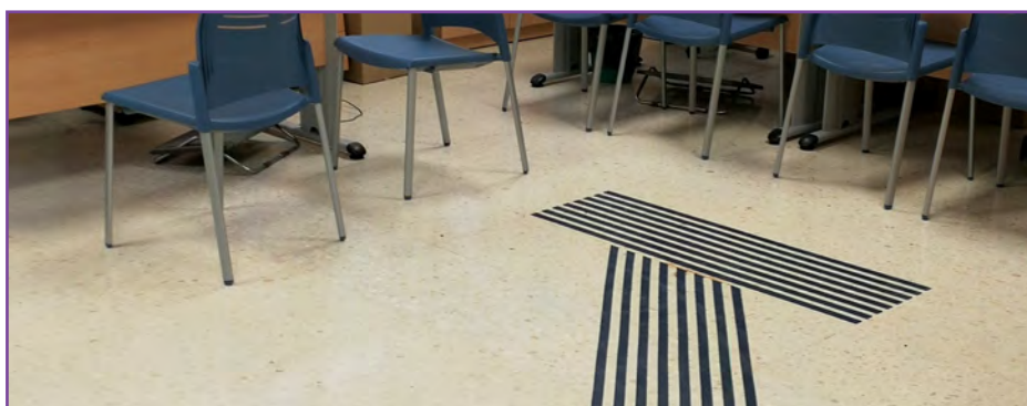
Imagen 134. Encaminamiento hacia un punto de atención al público.
