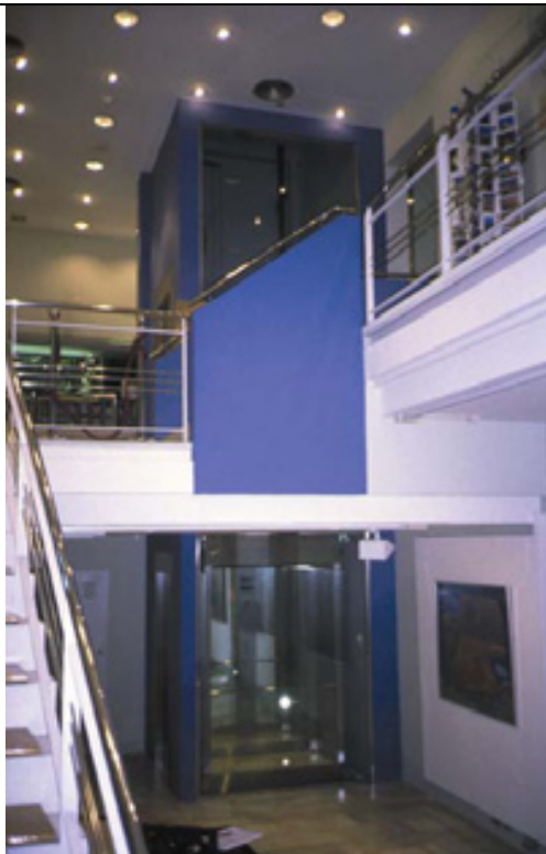
Foto2: Ascensor para comunicación vertical
