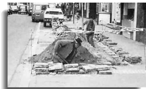
Protección inadecuada de obras.
