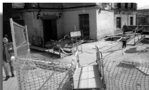
Ejemplo de itinerario practicable dentro de la propia obra merced a pasarelas y cintas de balizamiento que las unen. Según las necesidades de la obra, los recorridos se van cambiando.
