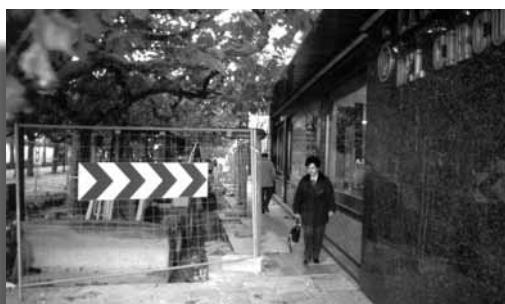
Trabajo por franjas. Cuando se ejecute la franja próxima a la fachada se utilizarán las pasarelas de peatones.
