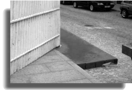
Detalle de ejecución de una acera provisional con lámina de polietileno, base de ladrillo y acabado de mortero.
