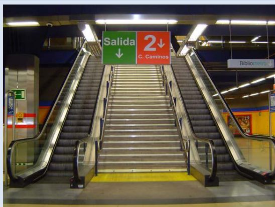
Ilustración 12. Ejemplo de señalización en una estación de metro.
