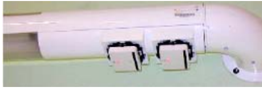
Imagen 5.- Receptores de las luces de cabecera.
