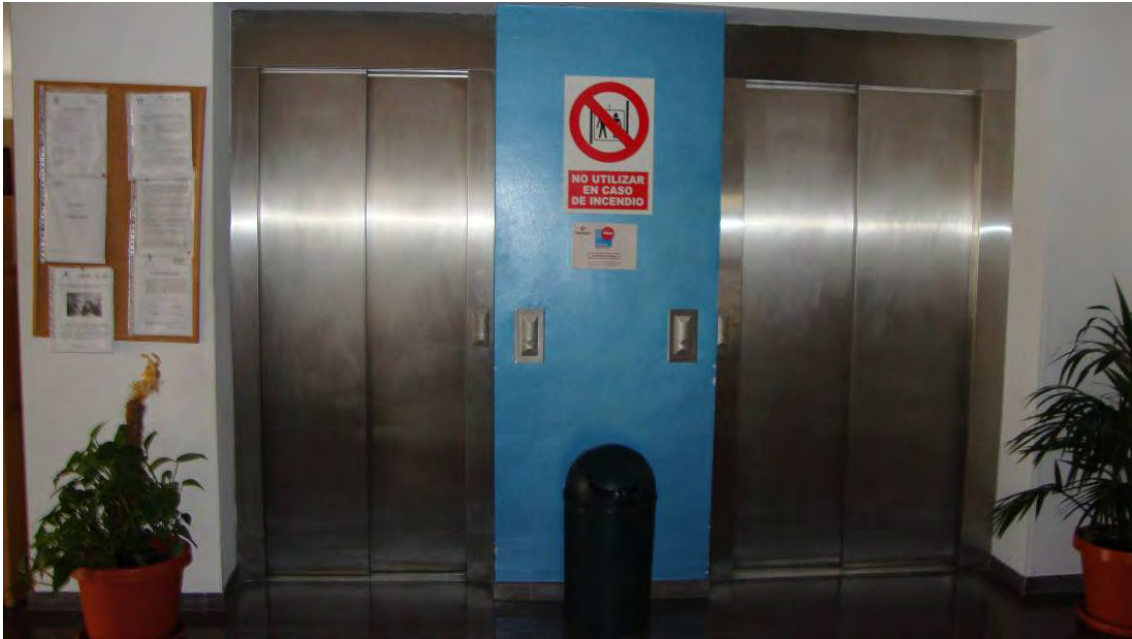
Ascensores Centro de mayores.
