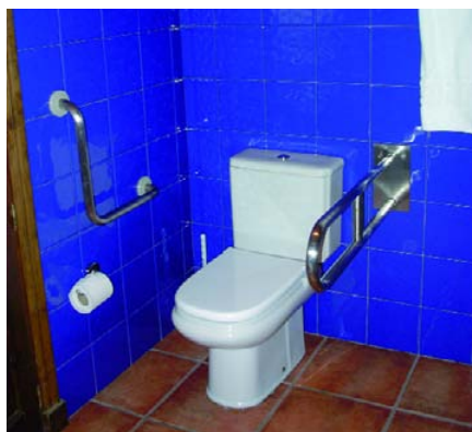
Figura 38: Inodoro con espacio lateral de transferencia, barra fija en el lado de la pared y abatible en el lado de acercamiento.
