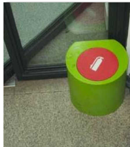
Imagen correcta señalización de extintores.
