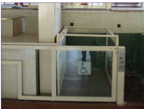
Imagen 20. Plataforma salva alturas instalada./ Elaboración propia.
