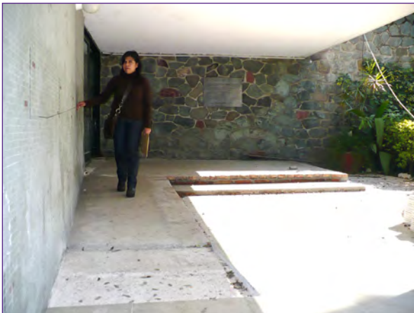
Imagen 8. Situación en la que se encontraba el acceso./ Elaboración propia.
