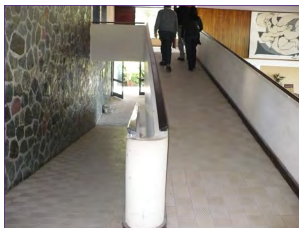
Imagen 14. Rampa sin barrales./ Elaboración propia.
