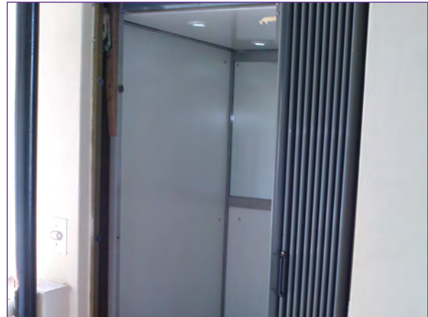
Imagen 18. Ascensor instalado./ Elaboración propia.
