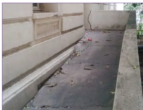
Imagen 5. Rampa lateral con piso destruido./ Elaboración propia.
