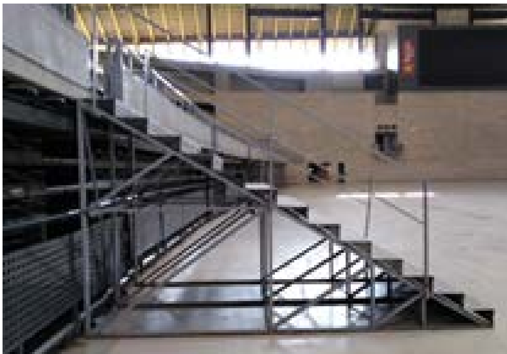
Imagen escalera sin protección adecuada y pasamanos no continuos
