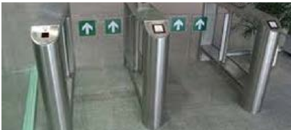
Imagen sistema de control de acceso accesible
