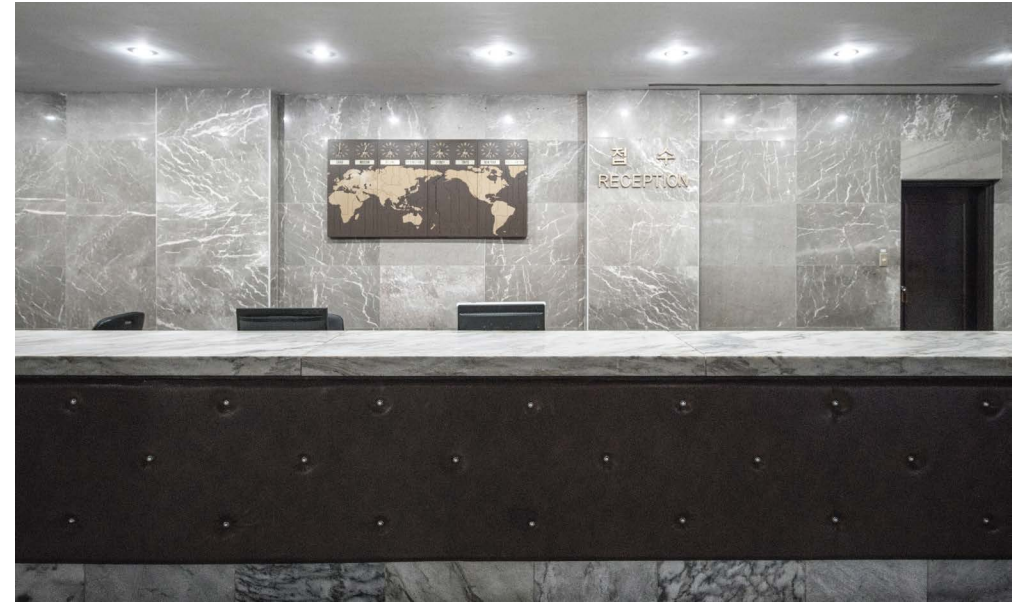
Ejemplo de barra con altura excesiva y carencia de zona rebajada y de aproximación frontal
